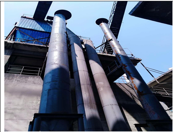
原煤粉磨系统排气筒
