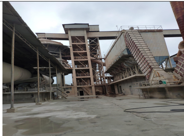
竖式冷却器布袋除尘器
